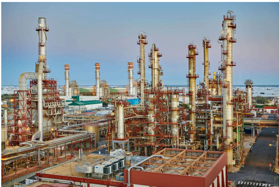
Cepsa instalará una de sus dos plantas del Valle Andaluz de Hidrógeno Verde en las inmediaciones de la refinera de La Rábida, en Palos de la Frontera (Huelva). CORTESÍA DE CEPESA
