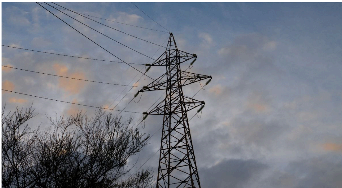
Tendido eléctrico, en Barcelona, Cataluña. / David Zorrakino (Europa Press)
